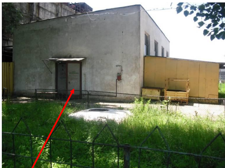
Stație de pompare
