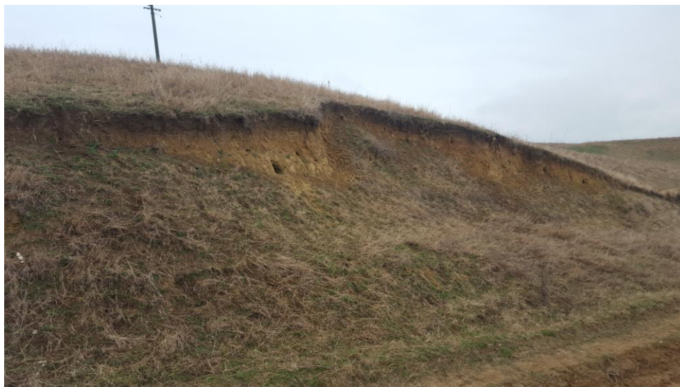
Foto 4.3 Zona cu eroziune severa
